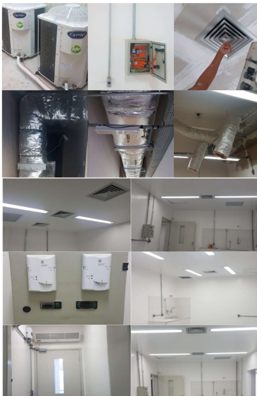
Figura 22 - Exemplo de instalação de um sistema Multi Split Dutado de 20 TR com automação para controle de temperatura e umidade
