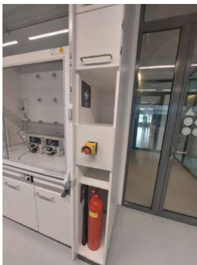
Figura 20 - Área de fácil acesso com abrigos para extintores, alarmes de emergência e caixas de primeiros socorros.
