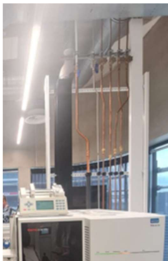
Figura 25 - Linhas de gases devidamente distribuídas e identificadas. ChemTech Centre/ OPCW.
