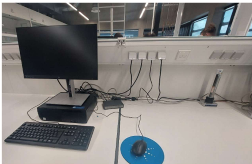
Figura 19 - Fiação embutida em duto externo. ChemTech Centre/ OPCW
