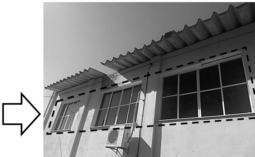
Fig. 82 - Janelas externas a serem substituídas por vidros fixos
