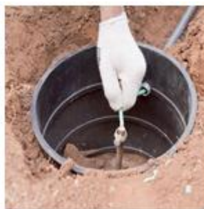
Fig. 65 - Caixa de inspeção/medição de Aterramento
