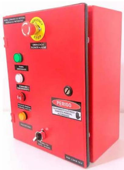
Fig. 125 - Quadro de bomba de incêndio (p/ 2 bombas)
