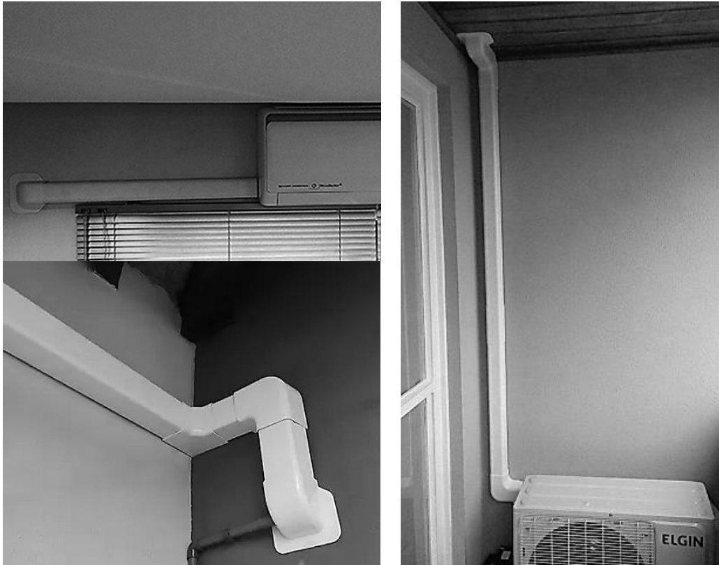
Fig. 94 – Padrão de acabamentos de tubulação de ar condicionado com canaletas de PVC
